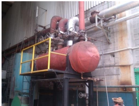
Figura 24. Manifould de distribución de vapor
