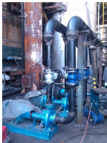
Figura 55. Reducidos en tubería
