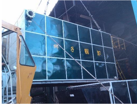
Figura 37. Ubicación del horno e intercambiador de calor
