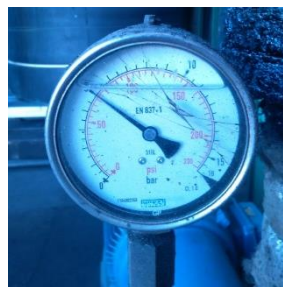
Figura 89. Manómetro de la bomba de aceite térmico
