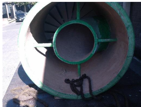
Figura 126. Interior del separador ciclónico de ceniza
