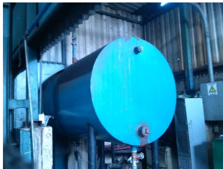
Figura 88. Tanque de agua de generador de vapor
