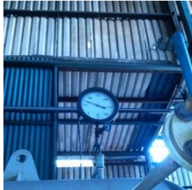
Figura 90. Manómetro del generador de vapor
