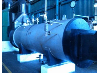
Figura 75. Generador de vapor
