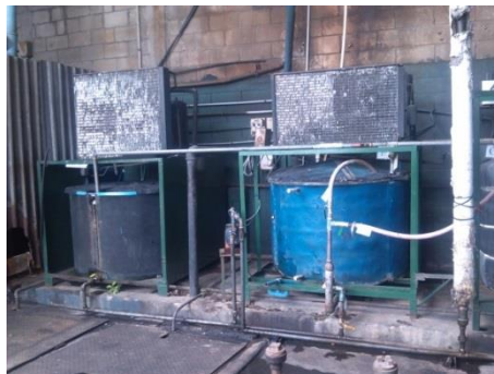
Figura 27. Chillers de agua fría
