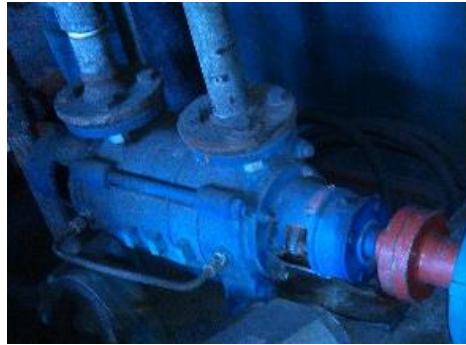
Figura 93. Bombas de agua
