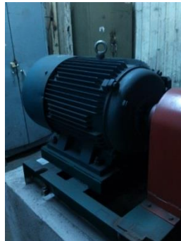
Figura 81. Motor de turbina de chimenea
