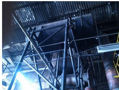
Figura 86. Tanque de expansión
