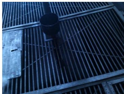
Figura 87. Tanque de almacenamiento
