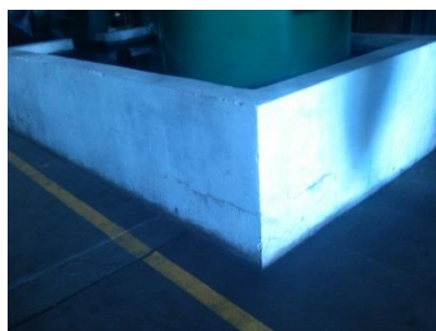
Figura 124. Pileta de retención de ceniza
