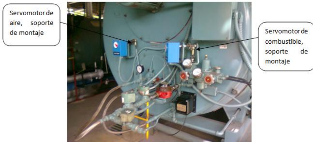
Figura 14. Ubicación de montaje de servomotores
