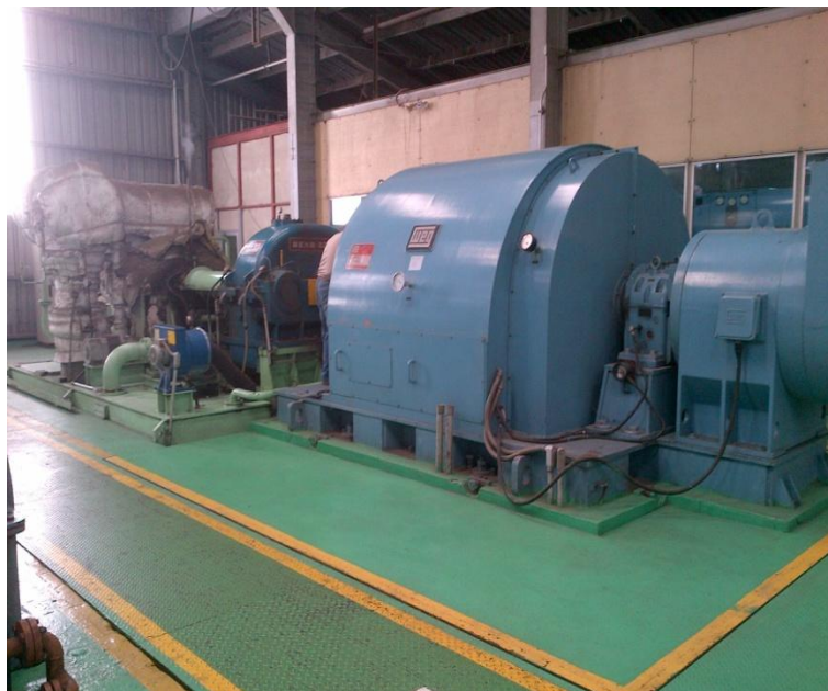
Figura 21. Turbogenerador de extracción
