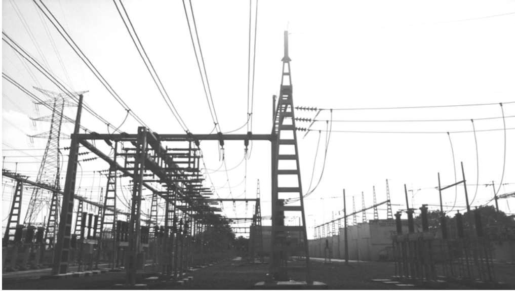
Vista de doble barra de 69kV
