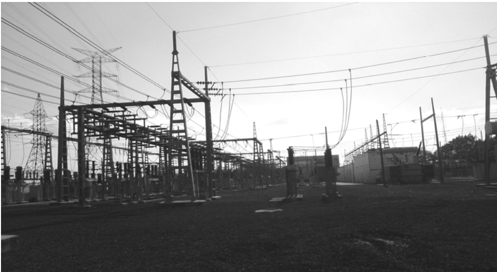
Doble barra de 69kV
