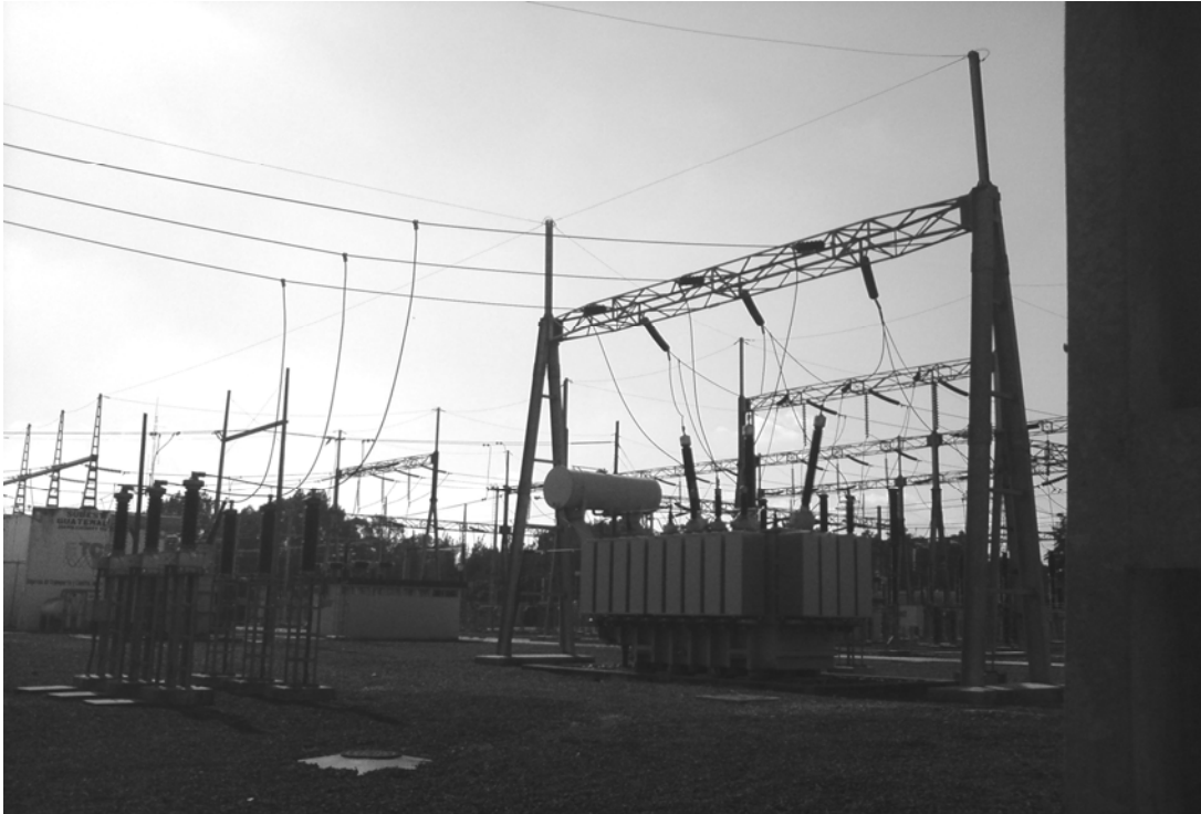
Figura 30. Vista del transformador trifásico de 100MVA
