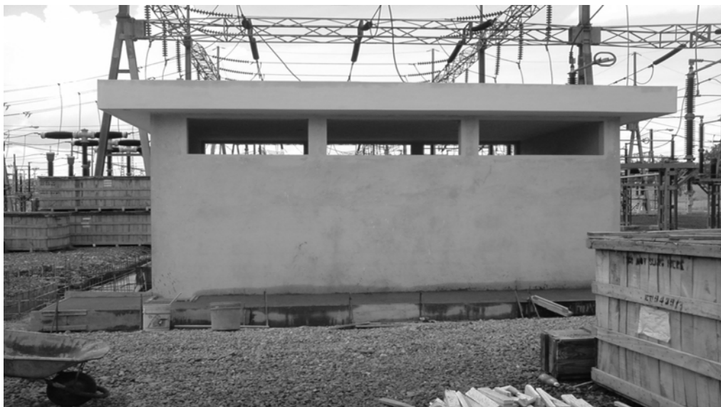
Figura 26. Caseta de control
