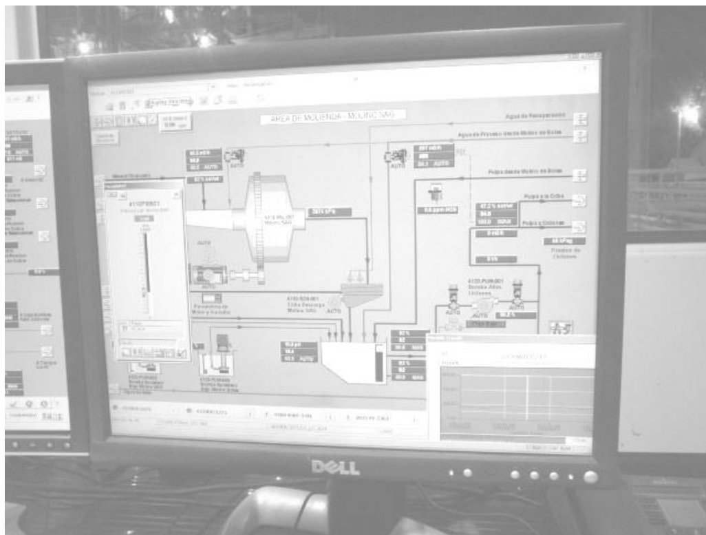
Figura 14. Una de las pantallas de cuarto de control del proceso de la planta ubicada en San Miguel Ixtahuacan
