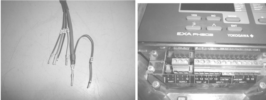
Figura 12. Cables del electrodo y bornero de conexión de indicador de pH
