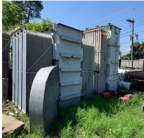
Figura 41. Equipos de gran volumen de aceite sin datos de PCB
