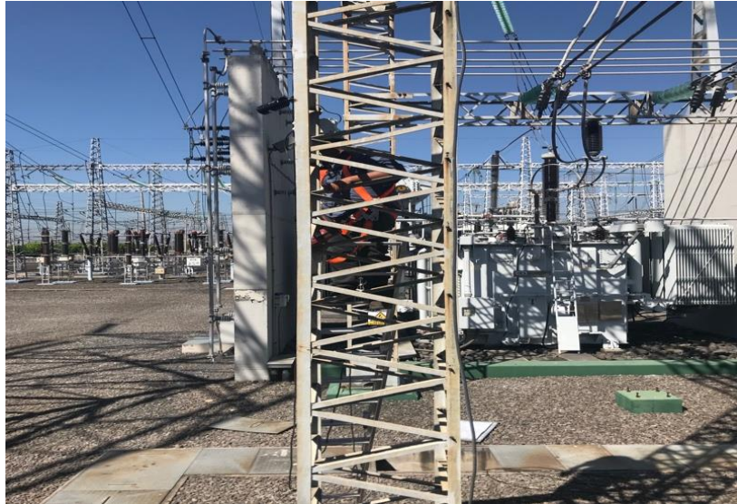
Figura 10. Transformadores en operación en Escuintla
