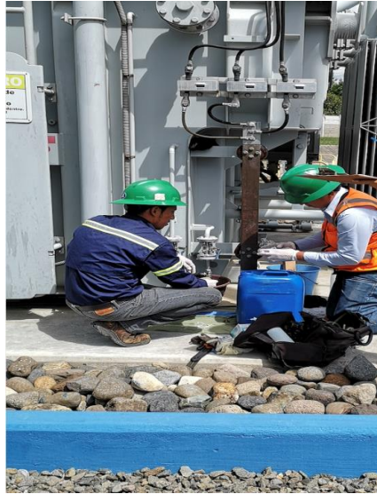
Figura 21. Proceso de toma de muestra de aceite en transformador 5
