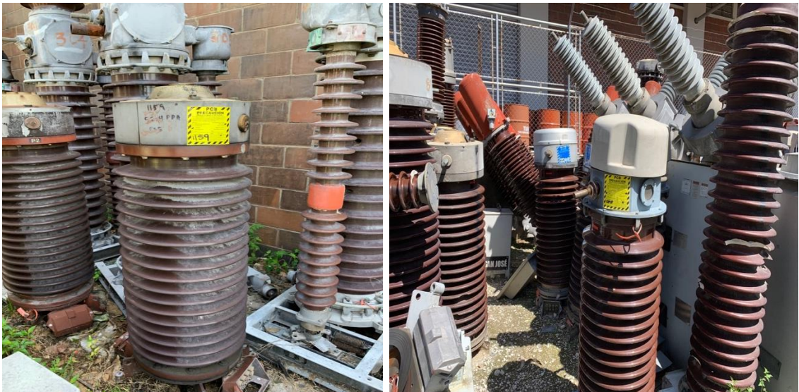
Figura 44. Equipos con información de PCB
