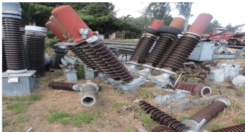
Figura 15. Interruptores de potencia fuera de operación
