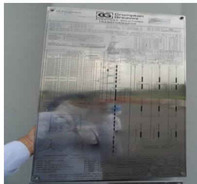
Figura 20. Placa de características banco 5
