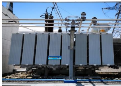
Figura 19. Transformador 230/69 kV fase R banco 5
