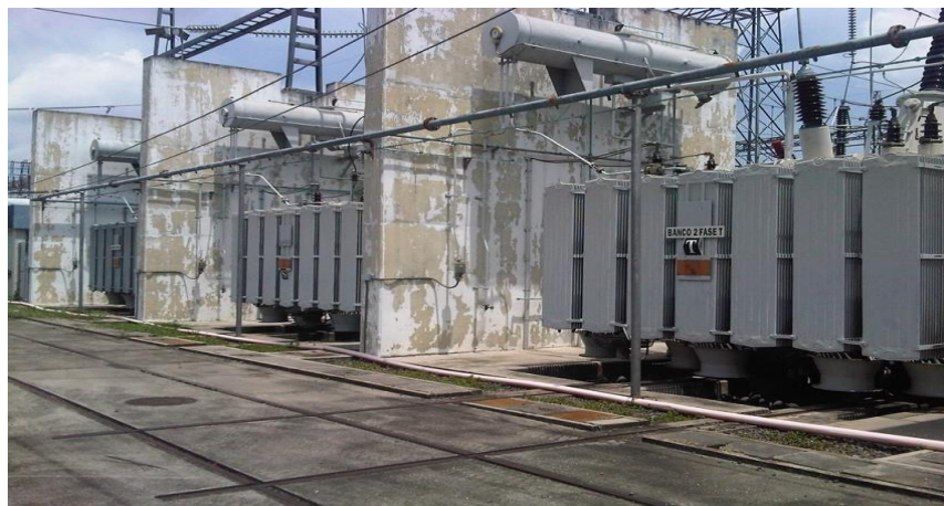
Figura 11. Transformadores en operación Guatemala Norte
