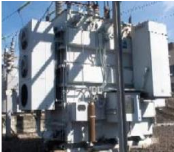
Figura 7. Transformador en operación
