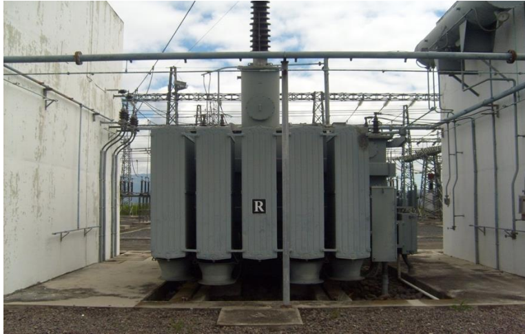
Figura 17. Transformador de gran volumen de aceite
