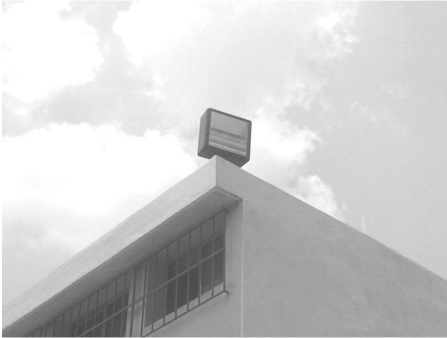
Figura 63. Lámpara de vapor de sodio a alta presión
