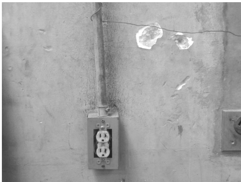
Figura 65. Tomacorriente en tubería expuesta
