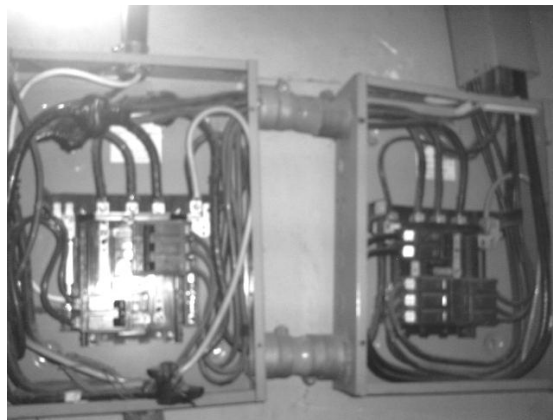
Figura 55. Tablero de distribución 8
