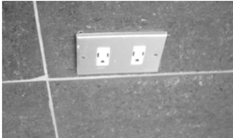
Figura 64. Tomacorriente de uso general
