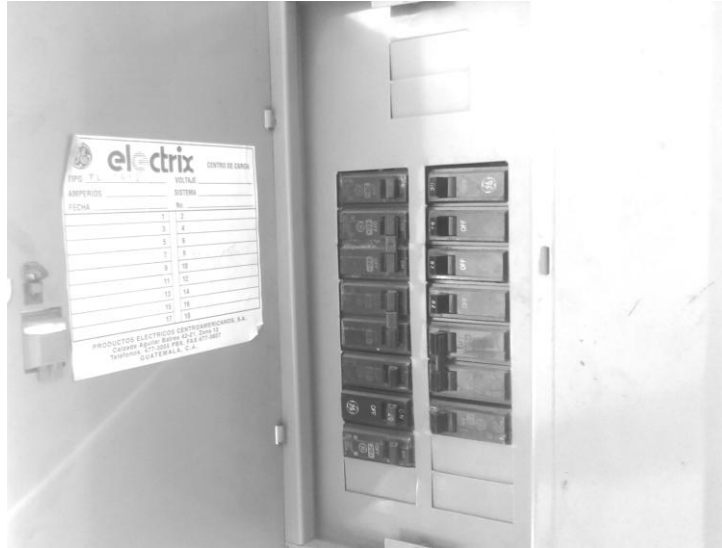
Figura 46. Tablero de distribución 4
