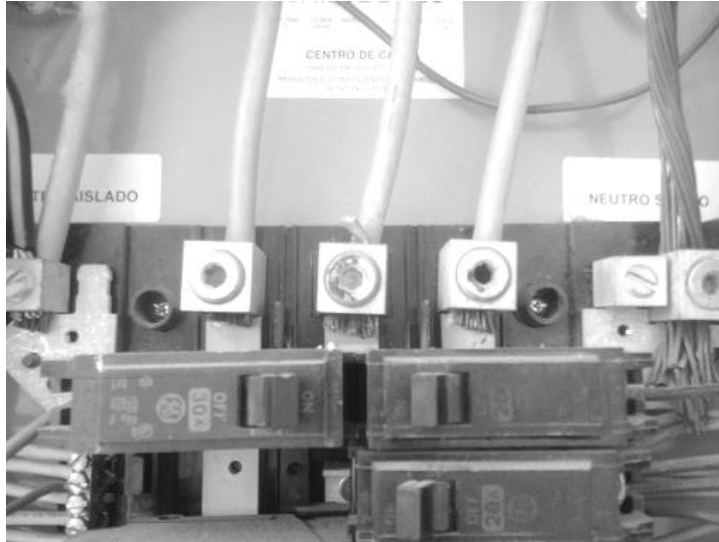
Figura 50. Estado de las conexiones en las protecciones
