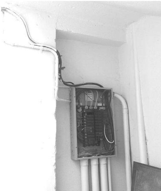
Figura 45. Tablero de distribución 2
