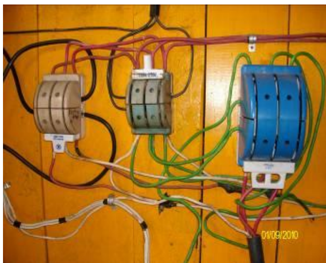
Fotografía No. 11 Tableros de Servicios
