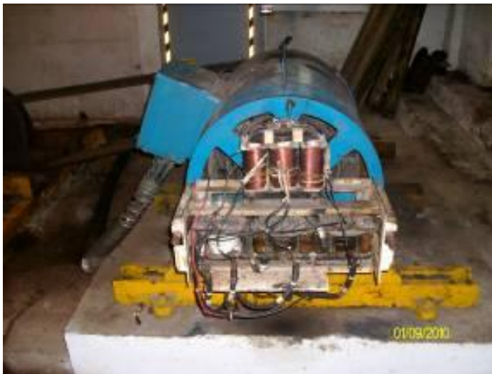
Foto No. 8 Generador Eléctrico
