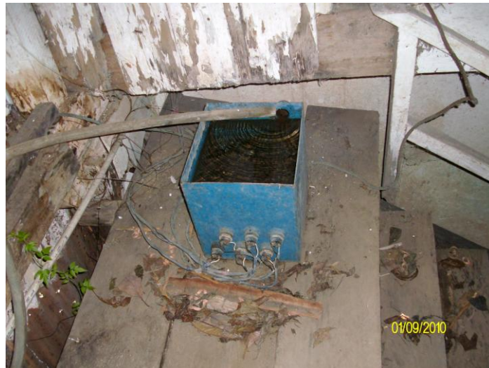
Fotografía No. 7 Resistencias de balastro sumergidas en agua
