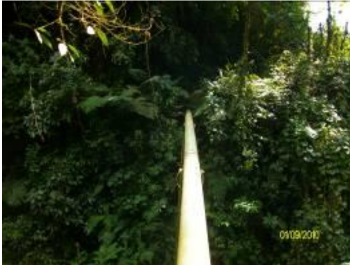
Fotografía No. 3 Tomas de agua mediante tuberías desde la montaña
