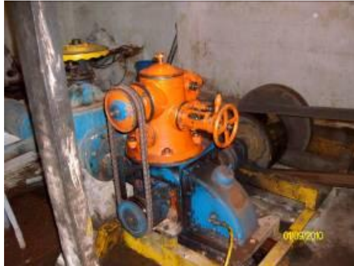
Fotografía No. 6 Turbina Michell-Banki
