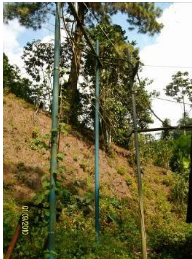
Fotografía No 9. Salida de la línea de transmisión
