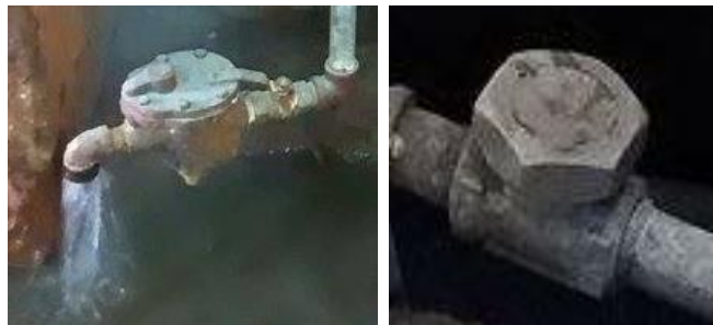
Figura 32. Trampas de vapor núm. 8 y núm. 3
