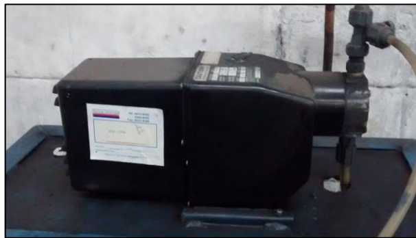
Figura 18. Bomba dosificadora de químicos
