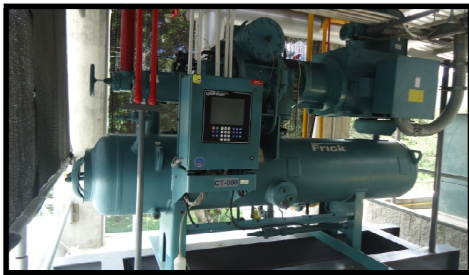
Figura. 18. Equipo sistema de refrigeración marca frick, compresor de tornillo
