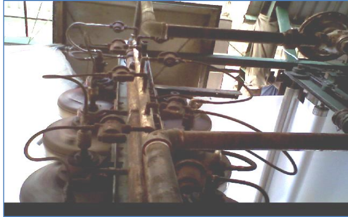
Figura 28. Torre de cilindros marca MCS
