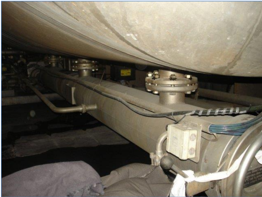
Figura 83. Trampeo en intercambiadores de calor
