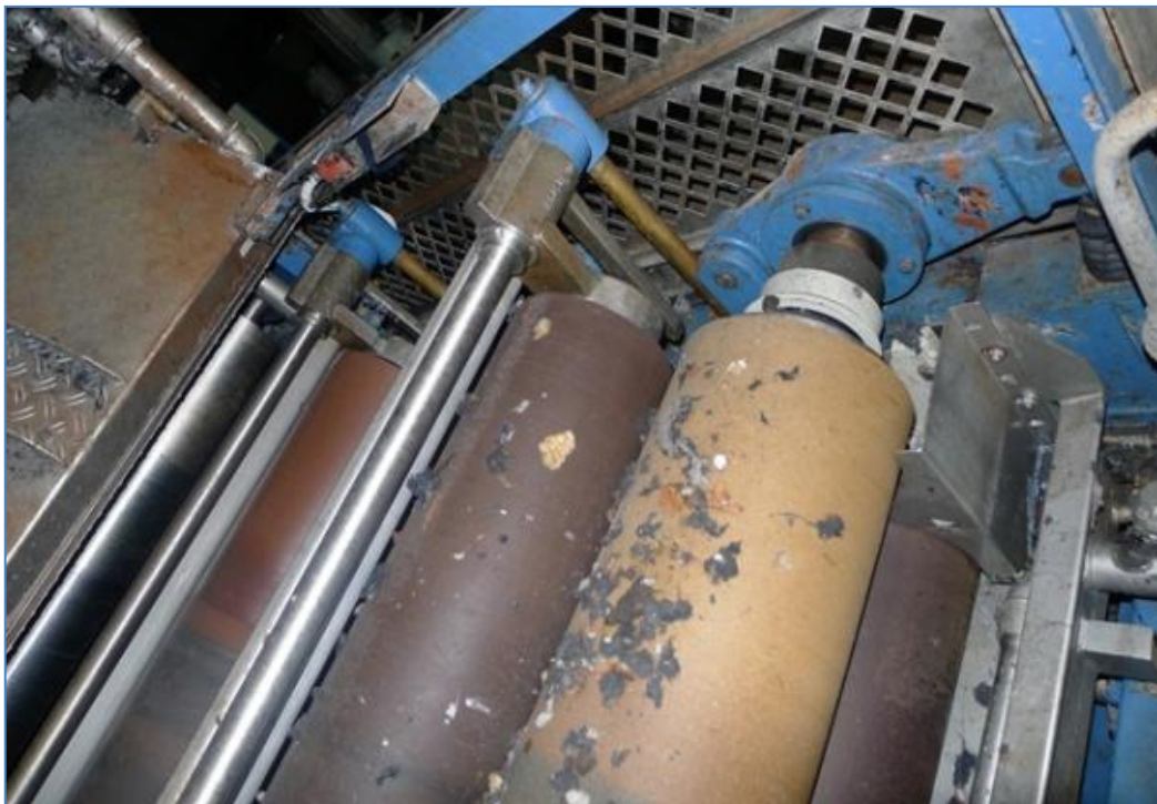
Figura 80. Trampeo en cilindros secadores de baja velocidad en engomadora Benninger
