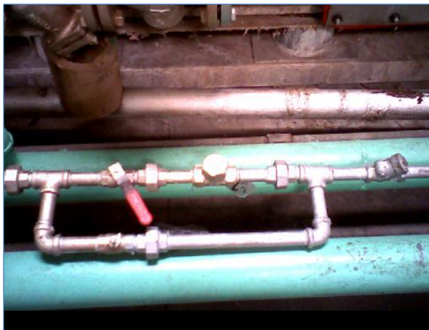
Figura 87. Trampeo en ramales de tubería de vapor
