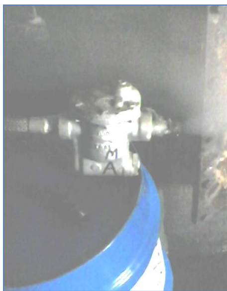
Figura 60. Falla en trampa de vapor modelo B-1H Spirax Sarco por insuficiencia de venteo de bióxido de carbono (CO 2 )
