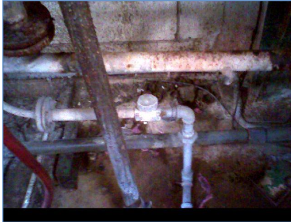
Figura 62. Falla en trampa de vapor termodinámica de disco modelo TD-52 por contrapresión
