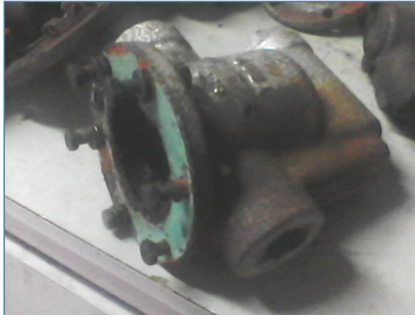
Figura 63. Falla en trampa de vapor de cubeta invertida por suciedad
