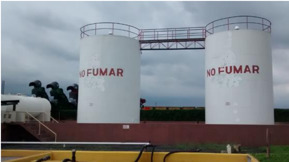
Figura 4. Tanque cilíndrico vertical
