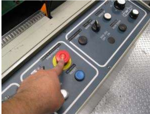
Figura 19. Paro de emergencia, botonera central, Cortadora 3
