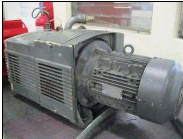
Figura 18. Motor de accionamiento principal de guillotina 5
