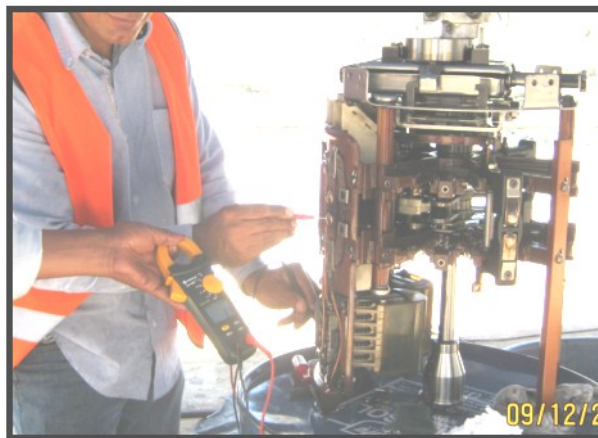
Figura 104. Medición de la resistencia de transición
