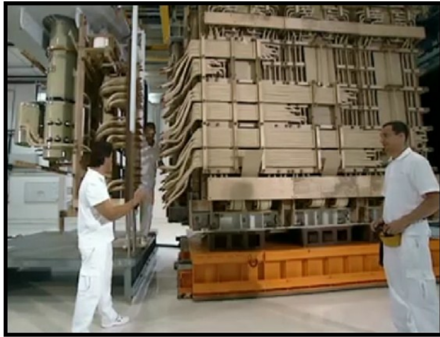
Figura 16. Transformador con derivaciones
