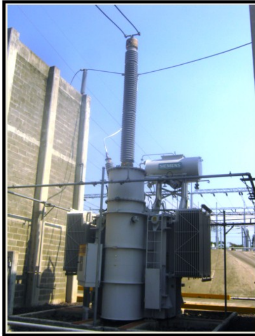
Figura 10. Reactor de potencia para una línea de 400KV
