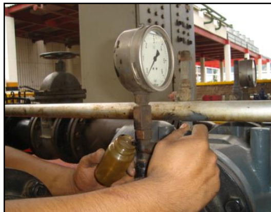
Figura 51. Punto óptimo para la toma de muestra de bunker
