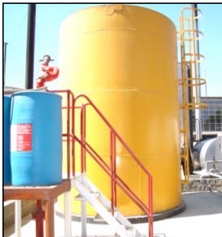
Figura 6. Tanque de almacén de aceite
