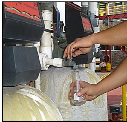
Figura 82. Punto óptimo para toma de muestra de agua en suavizador
