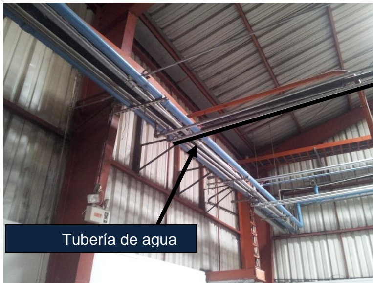
Figura 46. Tubería de agua Polytec
