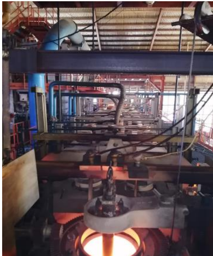
Figura 12. Vista canal alimentador de vidrio
