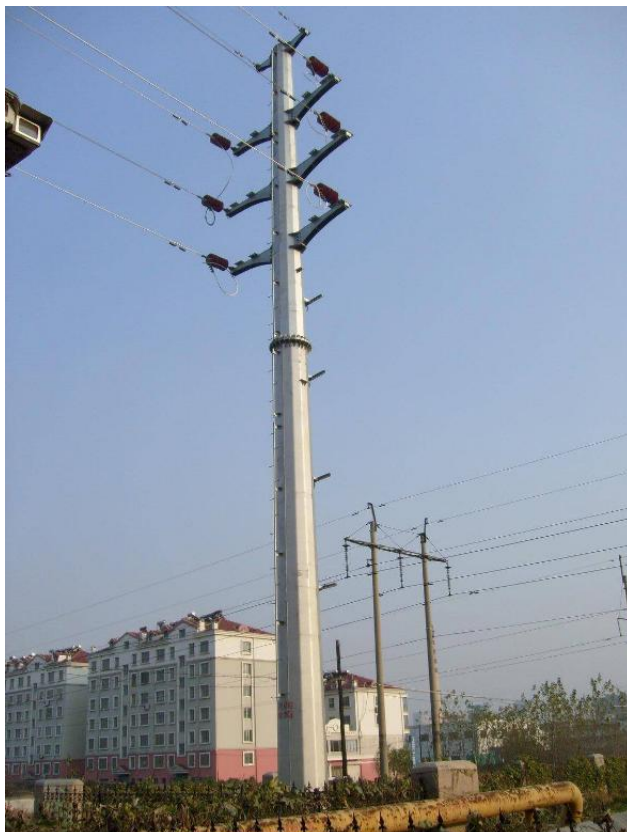
Figura 5. Torre fabricada de acero tubular
