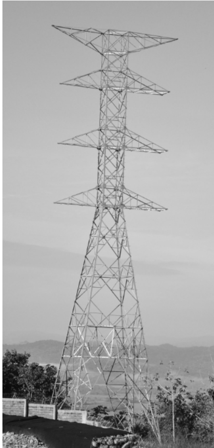
Figura 17. Torre de celosía utilizada en líneas de transmisión
