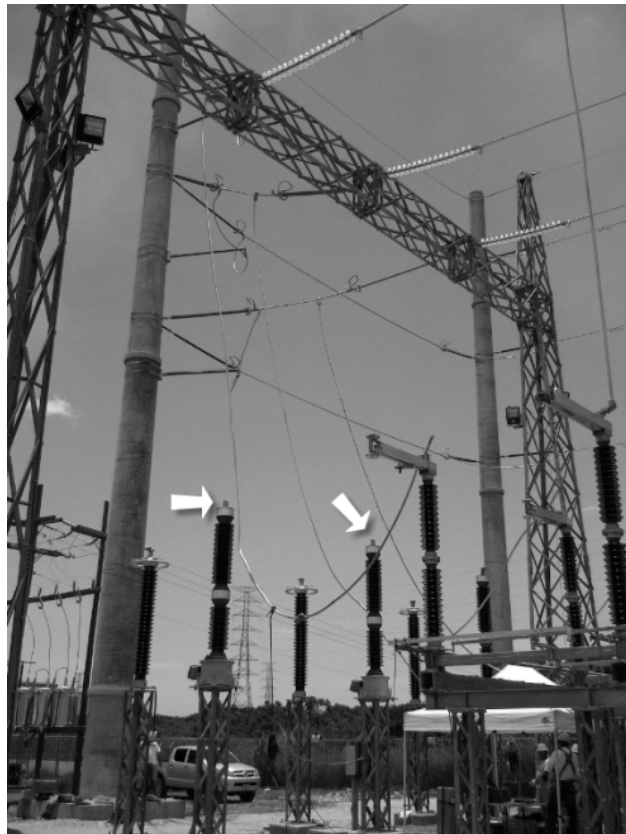
Figura 40. Línea de transmisión desconectada de equipos primarios
