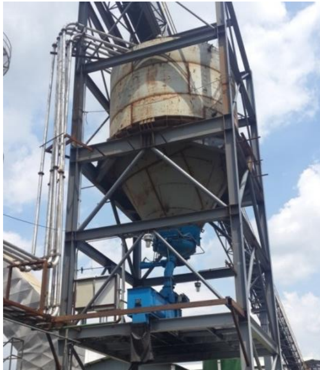
Figura 5. Silo de cenizas
