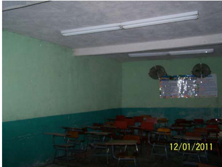
Figura 61. Iluminación terminada con las luces apagadas
