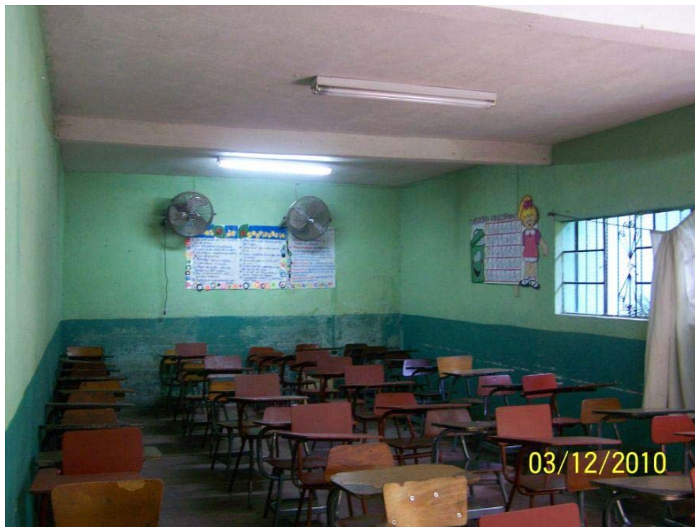
Figura 54. Iluminación antes de la remodelación
