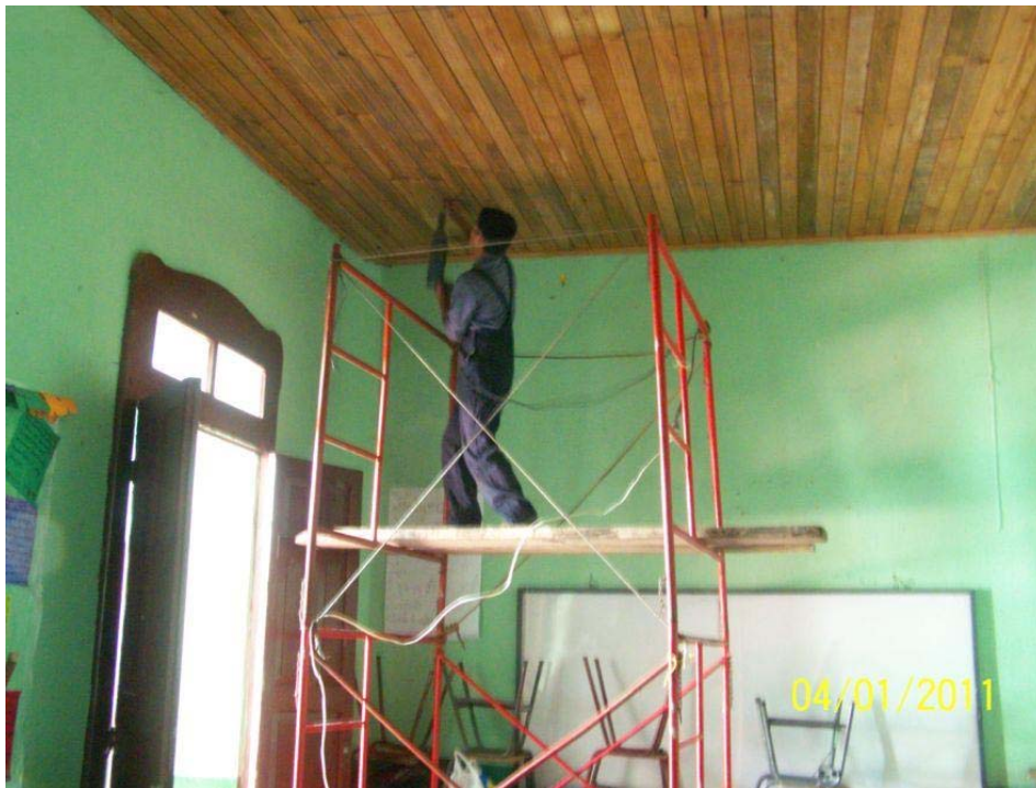
Figura 48. Marcaje de plafoneras
