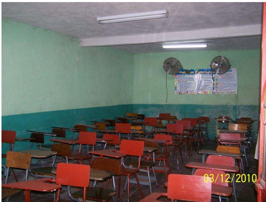
Figura 53. Iluminación antes de la remodelación
