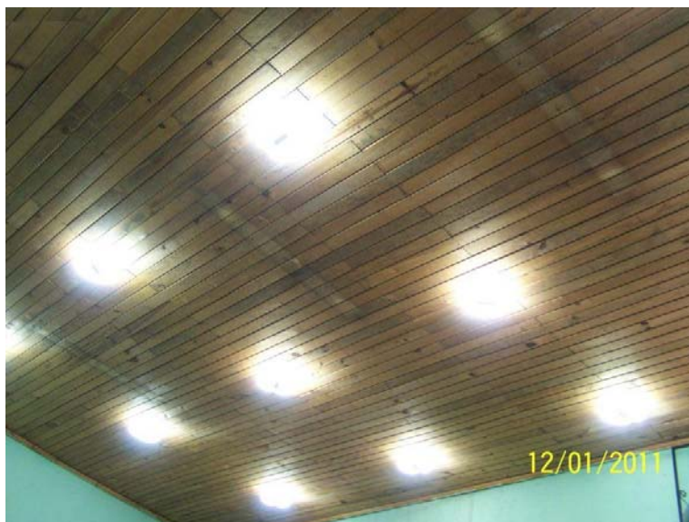
Figura 37. Vista final de las luminarias instaladas y energizadas
