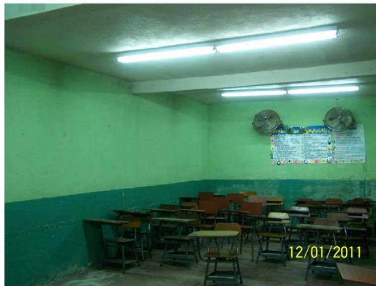
Figura 62. Iluminación terminada con las luces encendidas
