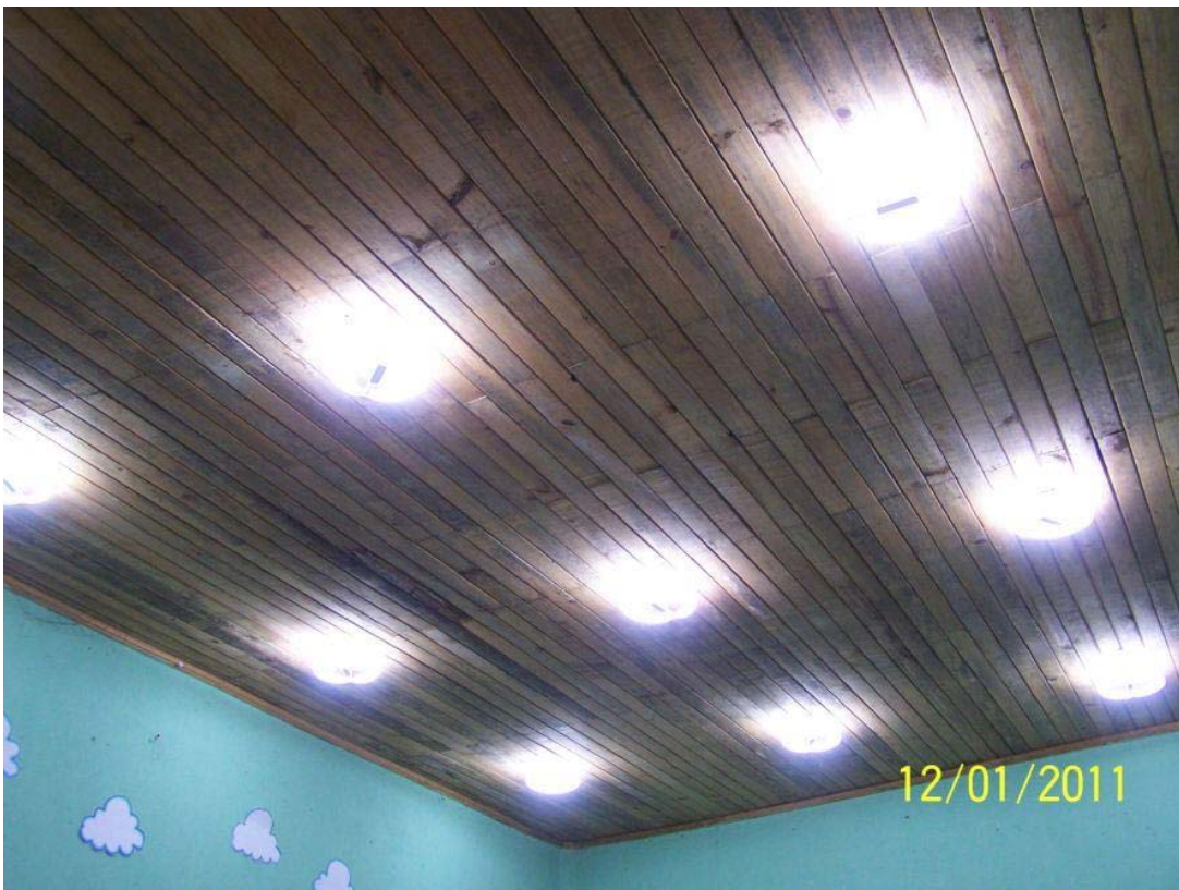
Figura 50. Iluminación del aula
