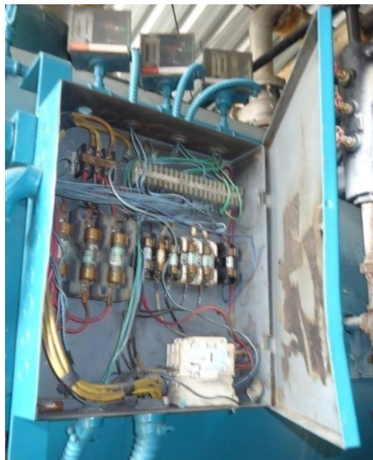
Figura 33. Control programador, caldera 1
