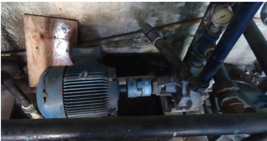
Figura 26. Bomba de alimentación de agua de la caldera 2
