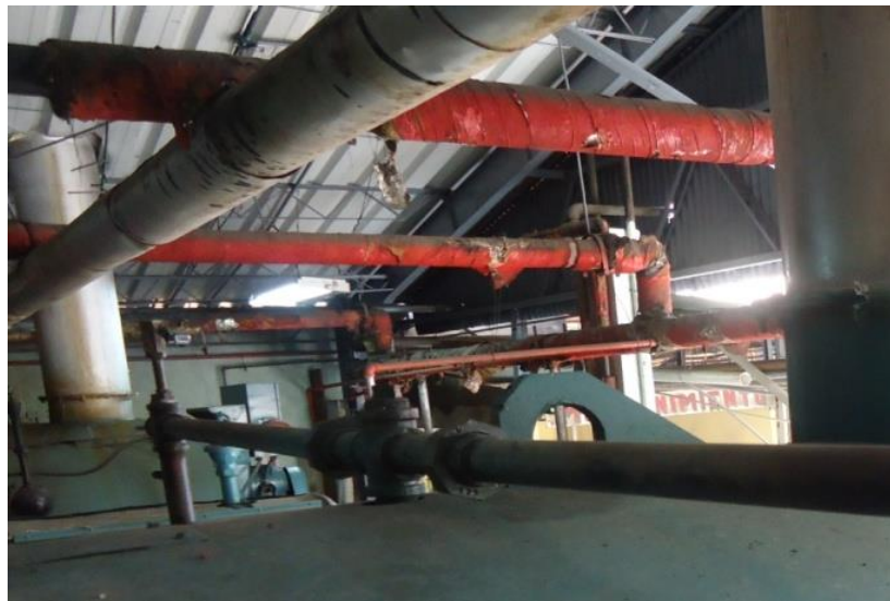
Figura 18. Tubería de vapor en cuarto de calderas
