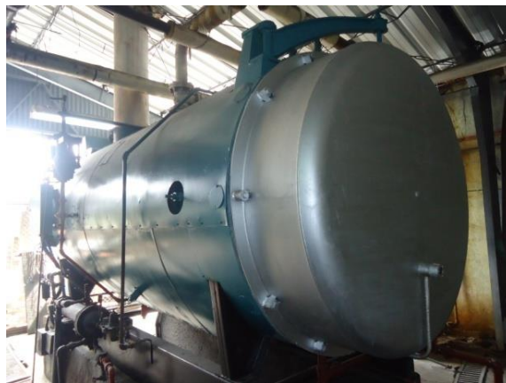
Figura 30. Puerta trasera, caldera 1
