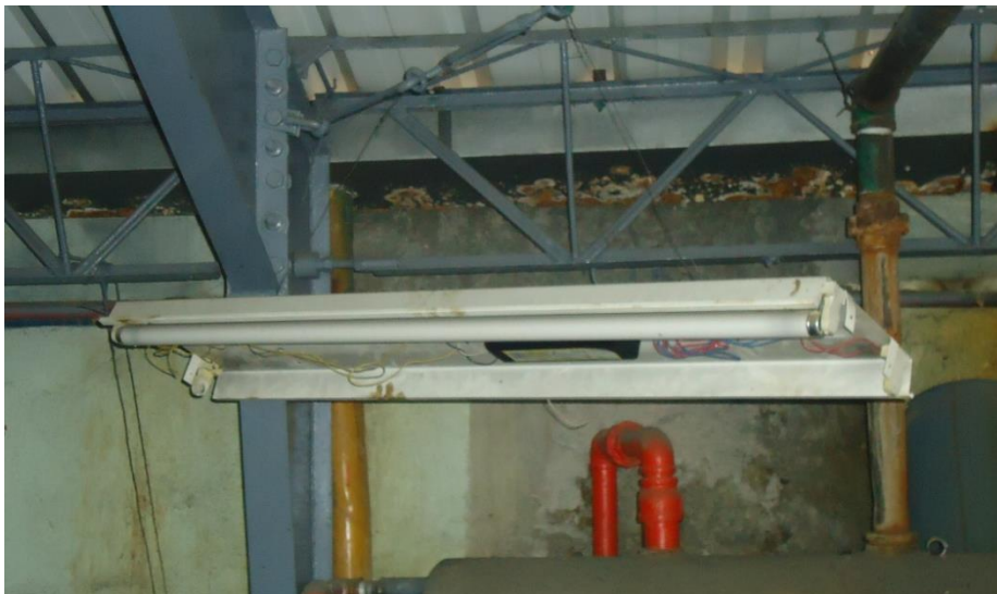
Figura 15. Iluminación cuarto de calderas
