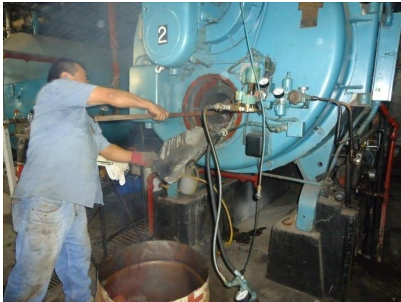
Figura 21. Mantenimiento preventivo del quemador
