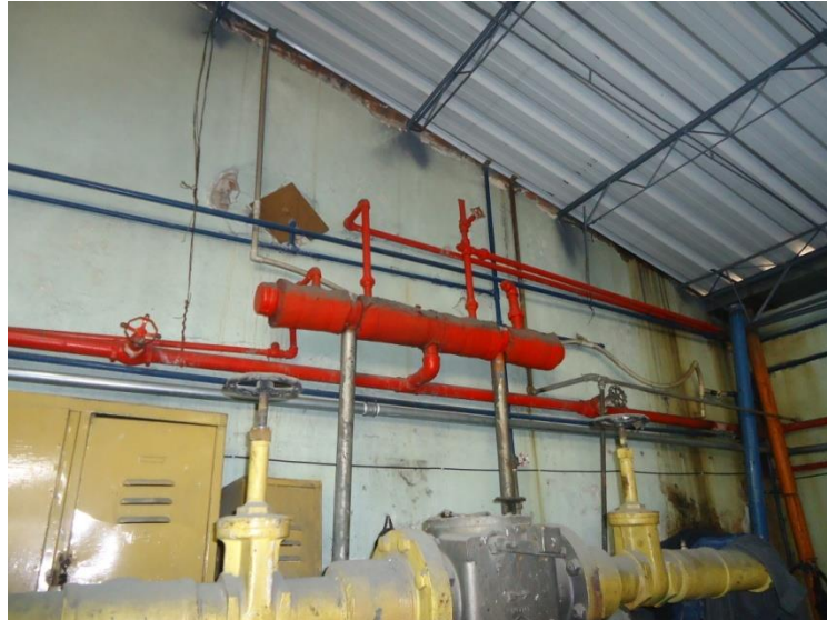
Figura 17. Tubería dentro del cuarto de calderas
