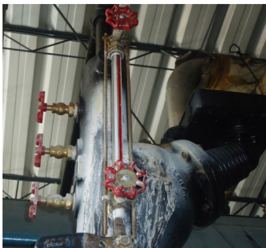
Figura 27. Control nivel de agua, caldera 1
