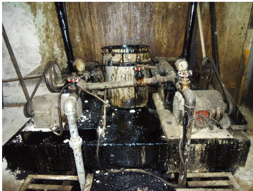
Figura 11. Bombas de combustible
