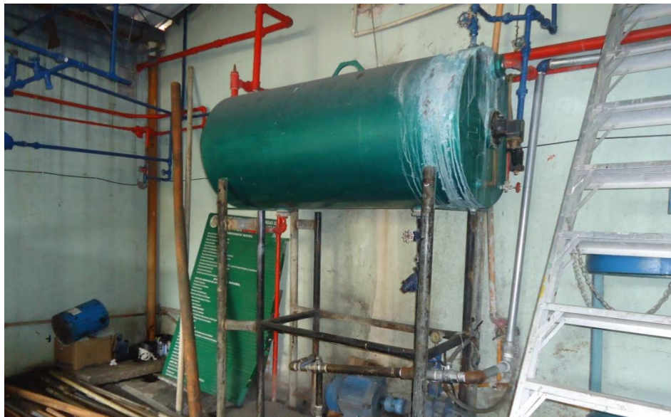
Figura 9. Tanque de condensado caldera número 1
