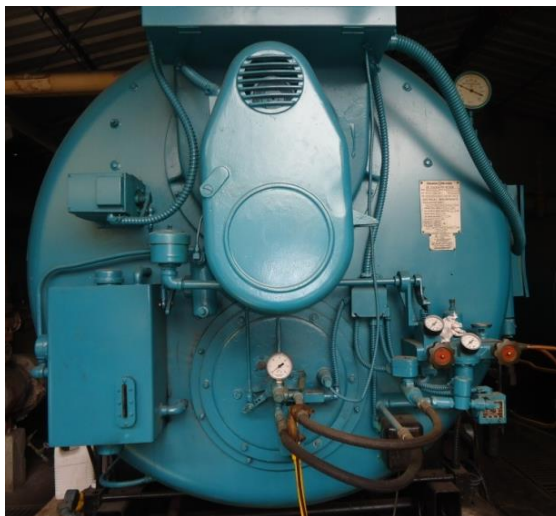
Figura 31. Puerta delantera, caldera 1
