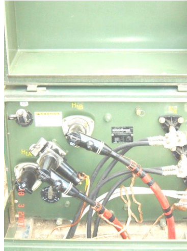
Figura 18. Panel frontal abierto mostrando codos rompecarga con pararrayos inserto y conectores para baja tensión
