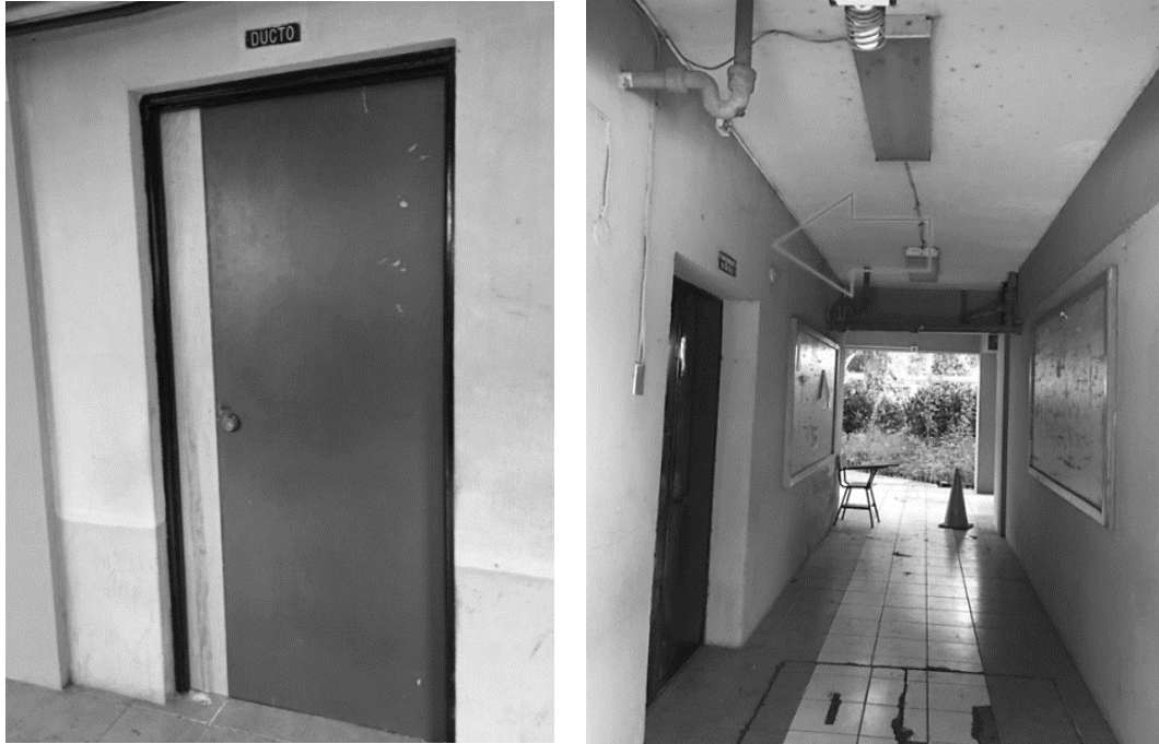
Figura 17. Ducto eléctrico y cuarto eléctrico en nivel 0, Edificio T-3
