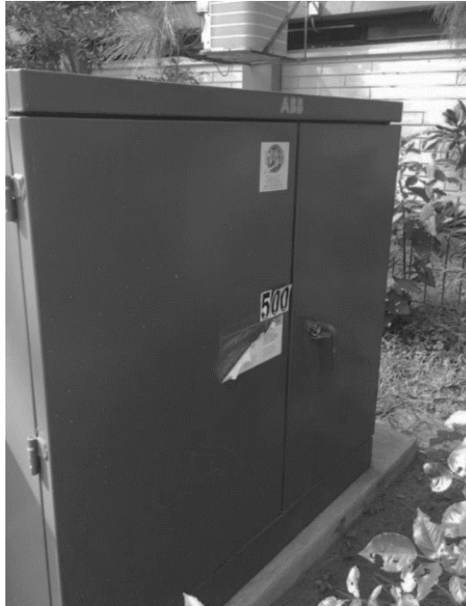
Figura 20. Transformador tipo pedestal de 500KVA, edificio T-3
