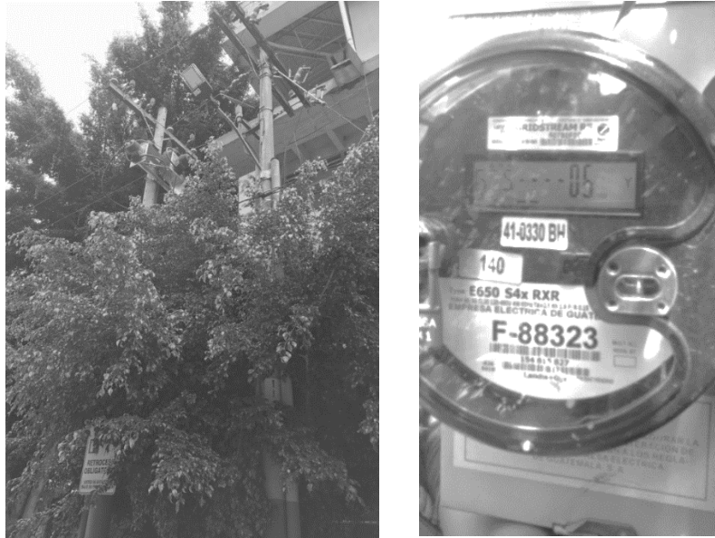
Figura 21. Medición primaria y contador eléctrico, edificio T-3
