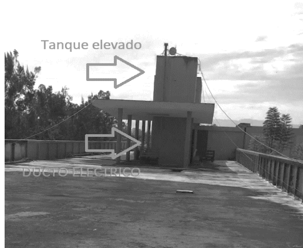
Figura 9. Tanque elevado y ducto eléctrico en azotea, edificio T-3
