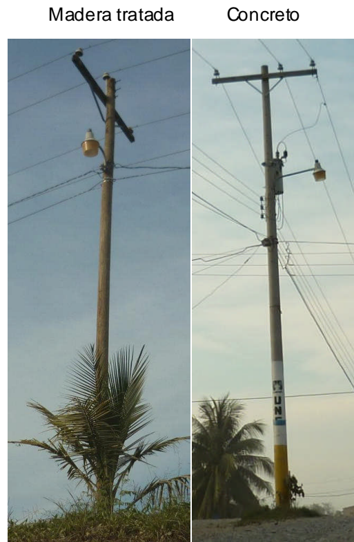
Figura 38. Soportes utilizados en la red de alumbrado público
