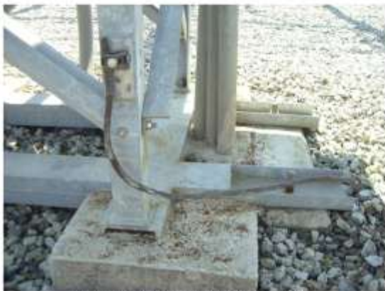
Conexión en la pata de estructura de acero
