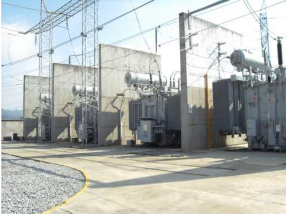
Figura 47. Transformadores de potencia, subestación Guatemala Este
