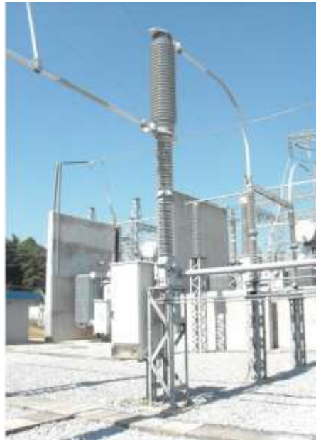
INTERRUPTOR DE POTENCIA
