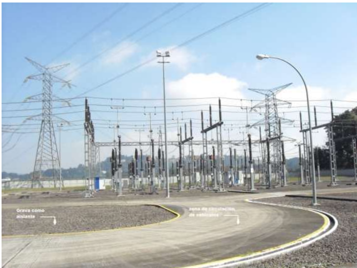
Figura 27. Grava en la subestación Guatemala Este, lado de 230 kV
