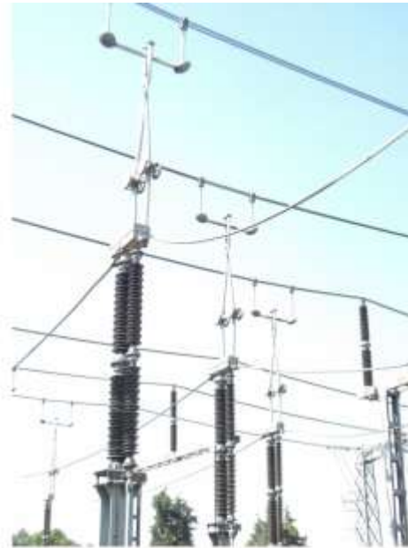
SECCIONADOR TIPO PANTOGRAFO
