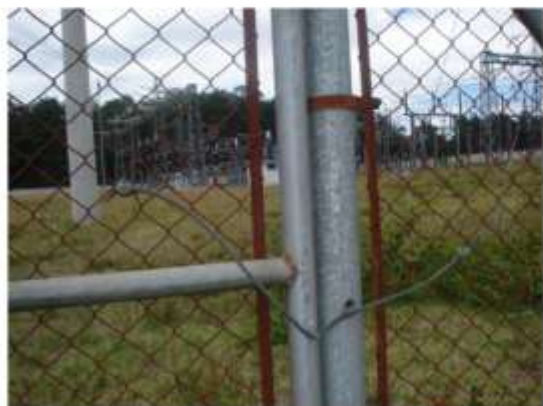
Conexión en la puerta de acero
