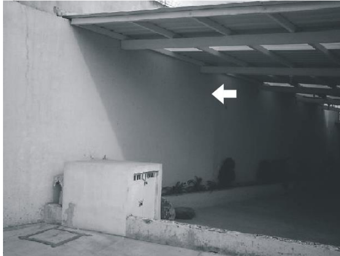
Figura 28. Espacio dispuesto para la instalación de condensador 2
