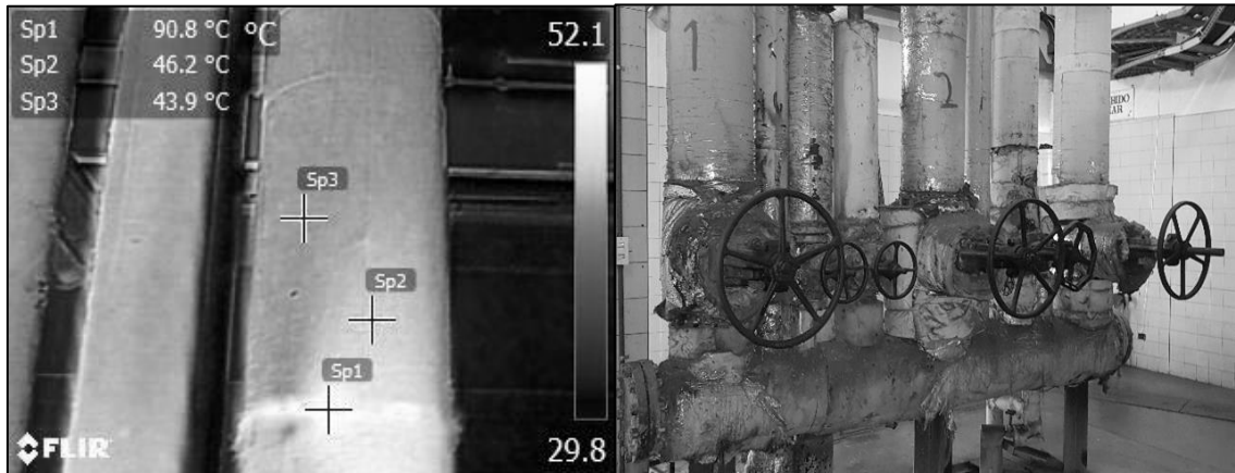
Figura 27. Termograma de llaves de paso y aislamiento térmico de tubería de distribución de vapor.
