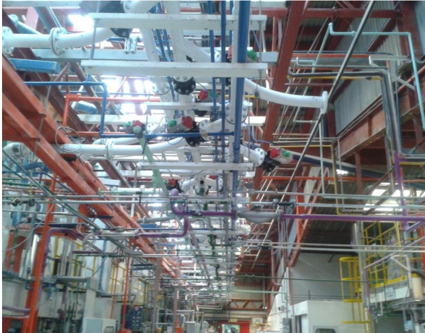
Figura 15. Instalación de tuberías de polvos
