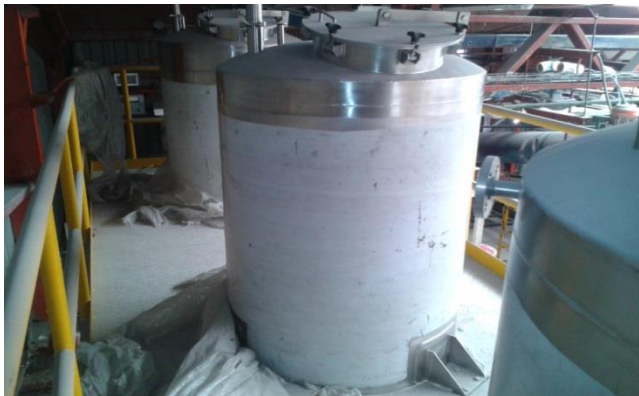
Figura 17. Tanque de perfume
