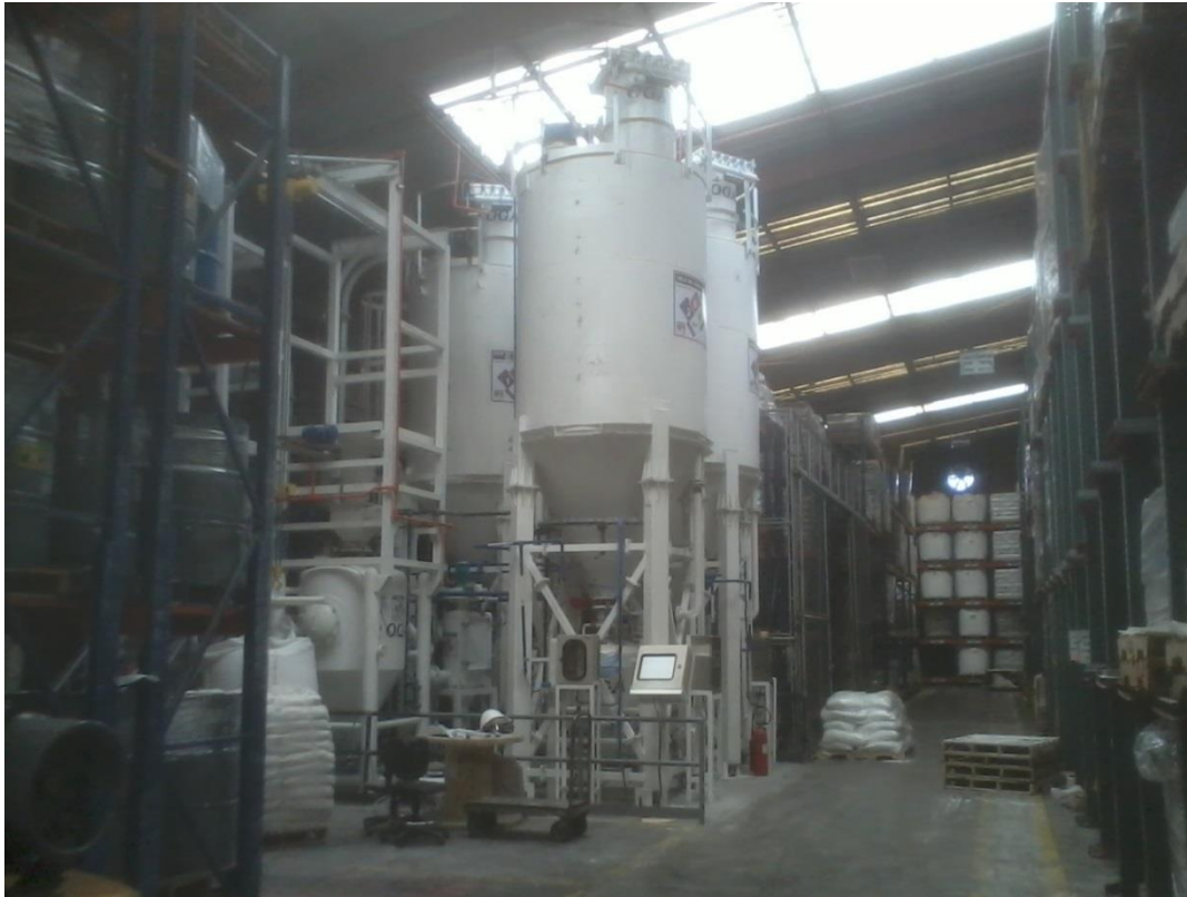
Figura 21. Silos de almacenamiento
