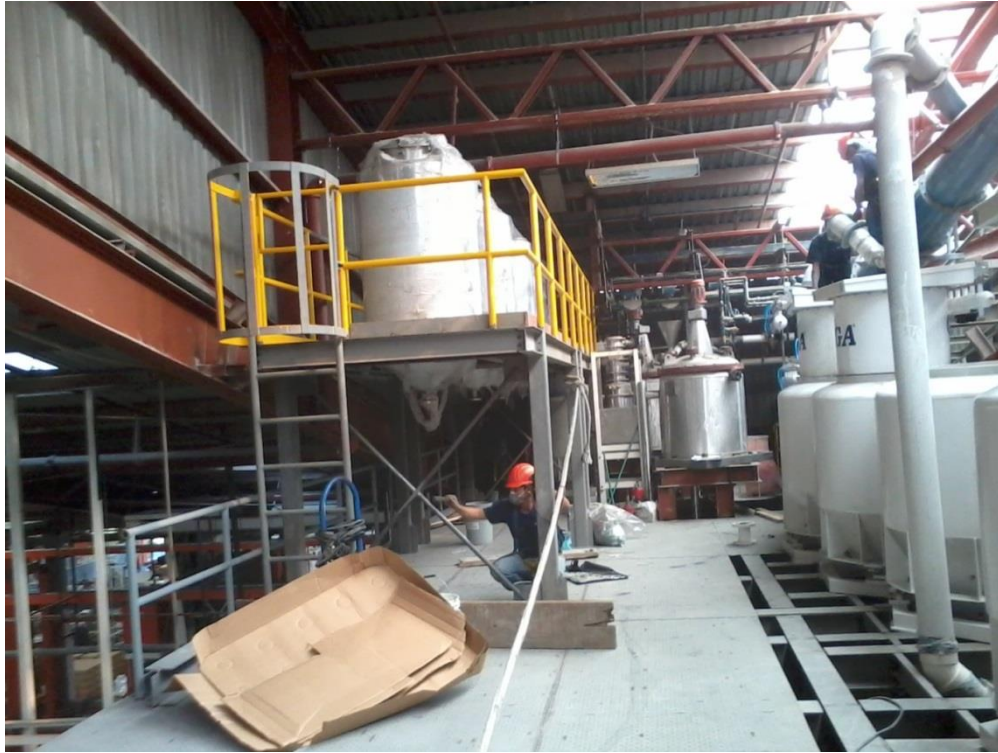
Figura 29. Estructura de tanques y perfumes
