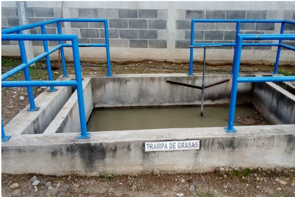
Figura 7. Trampa de grasas de planta de tratamiento de aguas residuales
