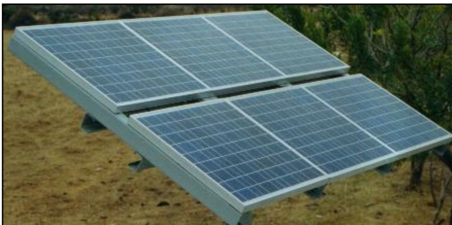
Figura 4. Módulos fotovoltaicos típicos y su estructura de soporte
