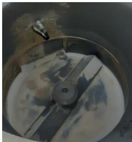
Figura 25. Forma interna del silo diario o tolva con su aspa, sensor de nivel y compuerta
