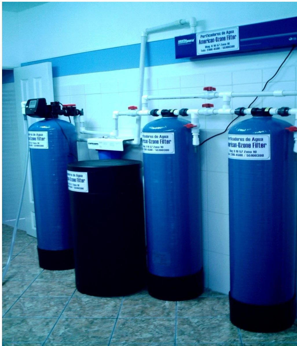
Figura 3. Sistema de purificación del agua
