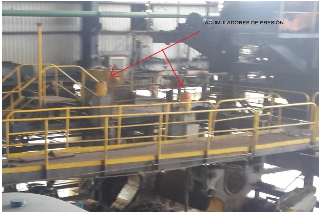
Figura 13. Acumuladores de presión, antes de desmontar para reparación
