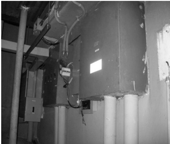
Figura 12. Ubicación de los tableros principales
