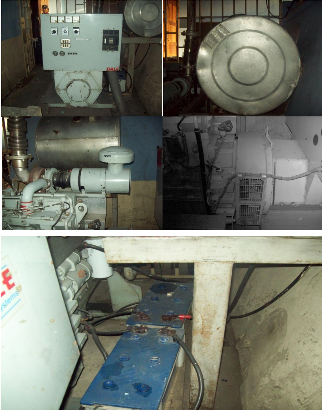
Figura 13. Planta eléctrica de respaldo
