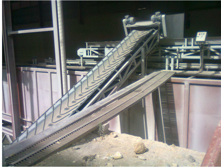
Figura 22. Riesgos en tolvas
