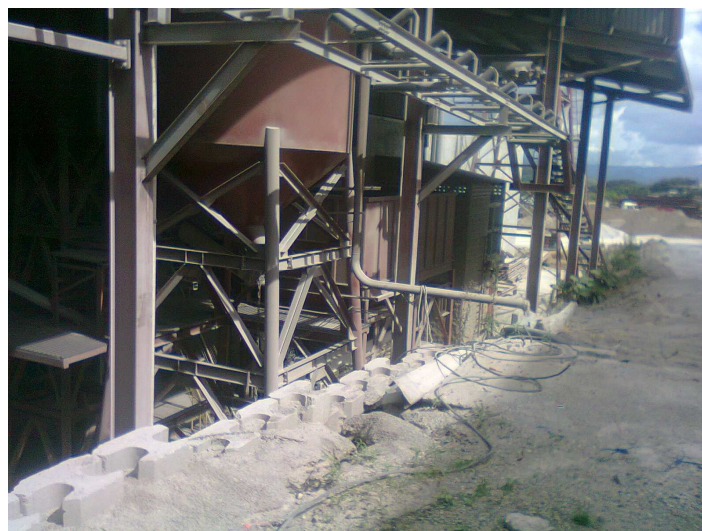
Figura 21. Riesgos en silos de cemento
