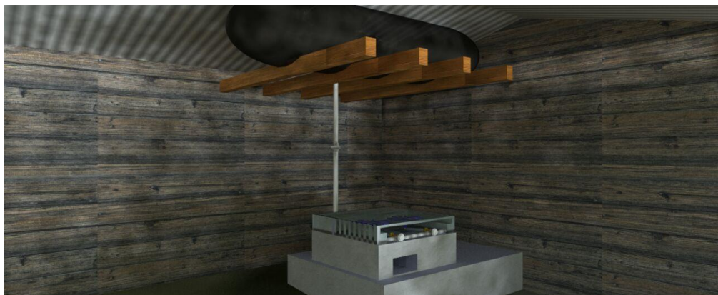
Figura 21. Reservorio de biogás instalado dentro de la vivienda
