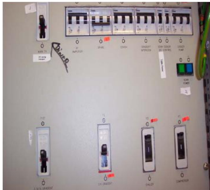
Figura 64. Interruptores termomagnéticos del panel PDU
