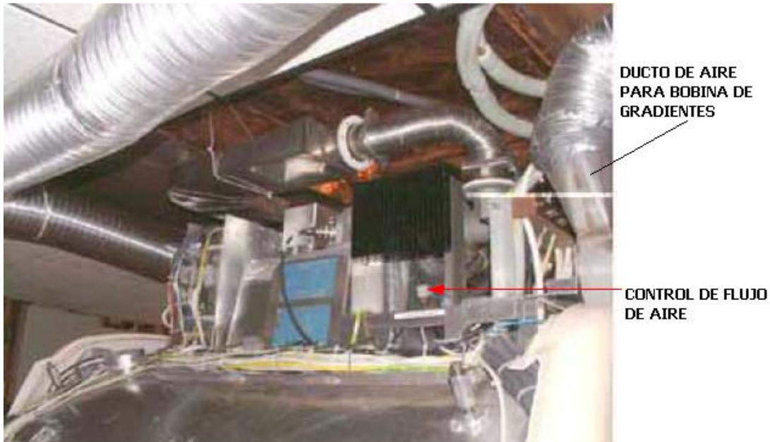
Figura 52. Ductos de aire para enfriamiento de bobina de gradiente
