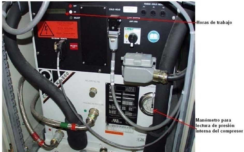
Figura 81. Vista frontal del compresor de helio gaseoso de alta pureza
