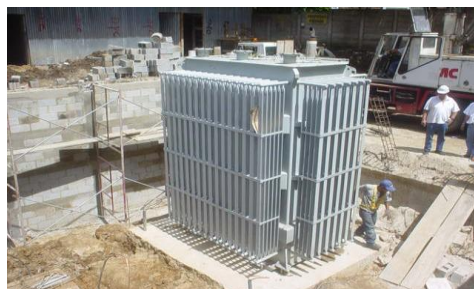
Figura 20. Transformador de potencia en subestación
