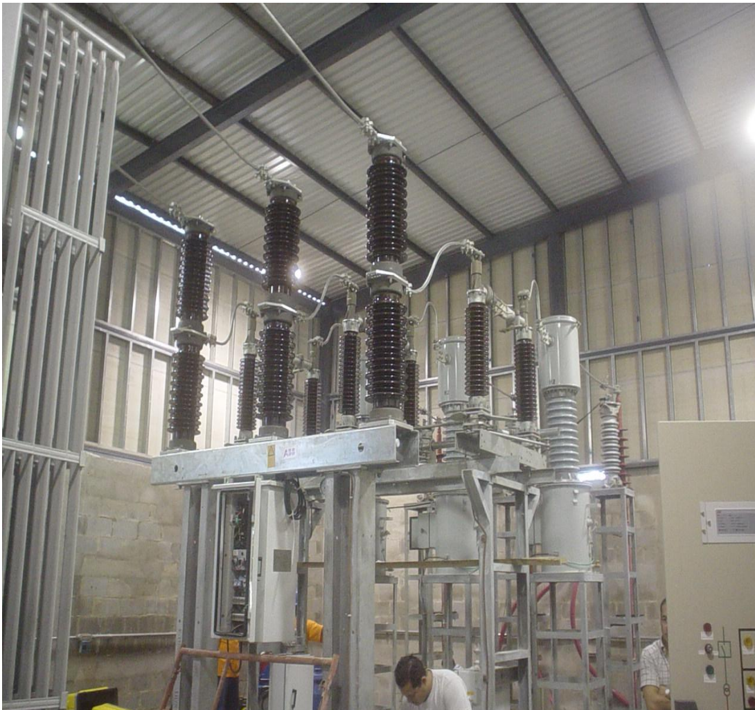
Figura 30. Subestación en el centro comercial Oakland Mall terminada
