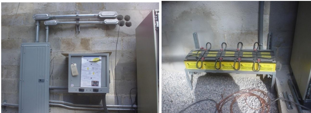
Figura 27. Cargador de baterías y banco de baterías
