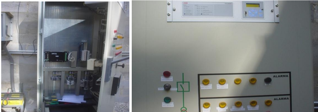
Figura 26. Interior y exterior del tablero de control
