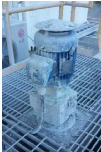
Figura 11. Motor del agitador de tanque de lodos
