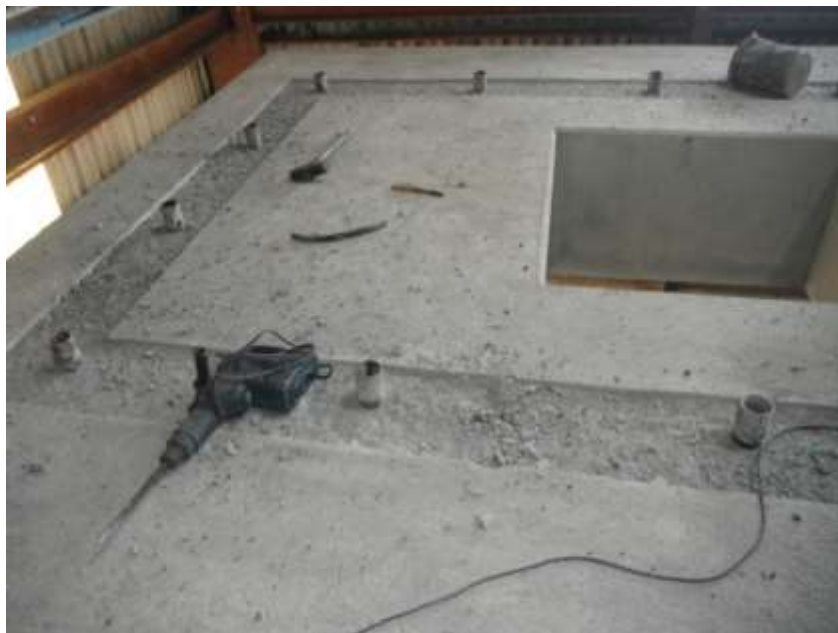
Figura 9. Superficie de la base de la turbina después del chipping
