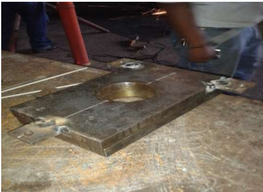
Figura 10. Platina de la turbina con sus tres placas de apoyo
