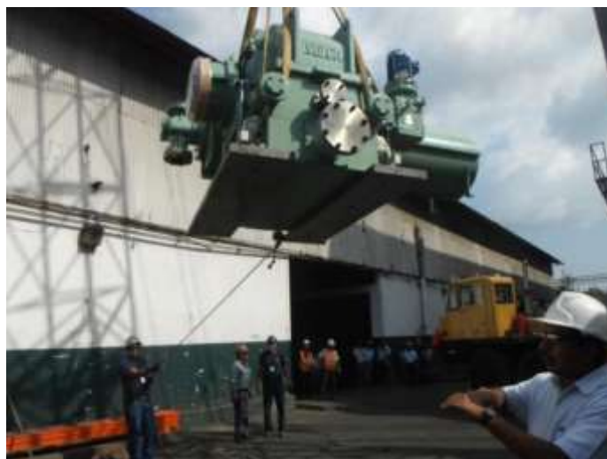
Figura 14. Instante en el que la caja reductora es trasladada a su base
