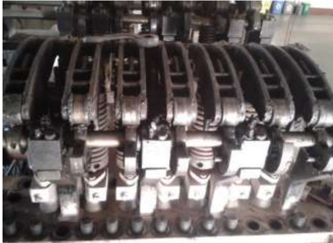
Figura 23. Válvulas de control principal de vapor
