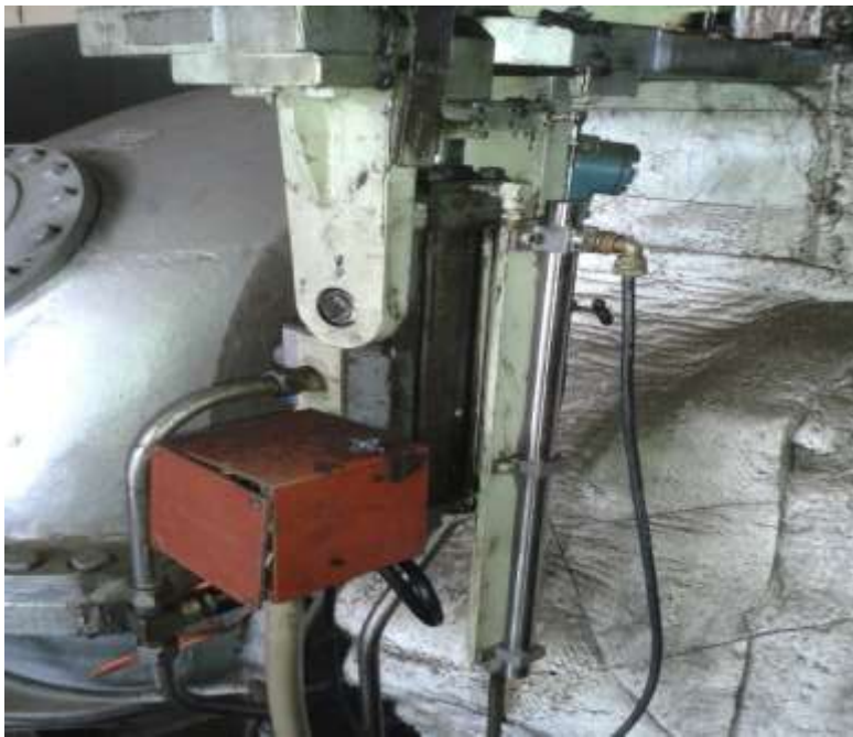
Figura 25. Cilindro hidráulico de control de vapor
