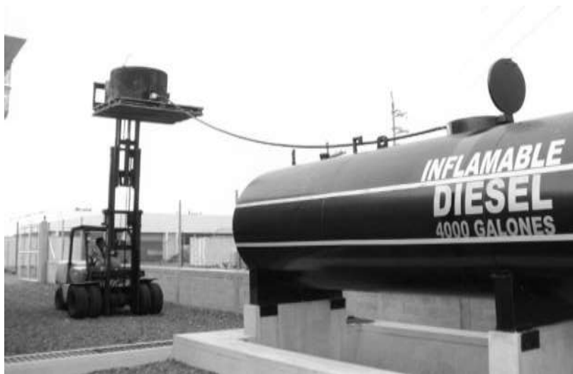
Figura 21. Llenado del depósito de combustible mediante un depósito auxiliar
