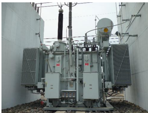
Figura 18. Transformador de potencia
