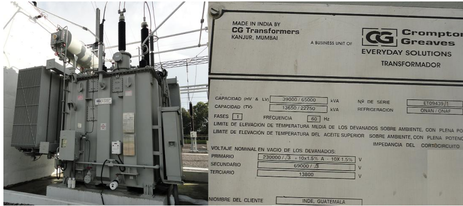
Figura 2. Transformador de potencia y datos de la placa
