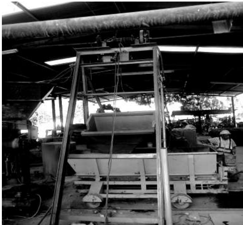
Figura 36. Guías de skip instalado
