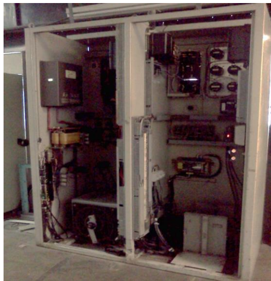
Figura 11. Vista posterior de uno de los tableros anteriores con equipo disperso
