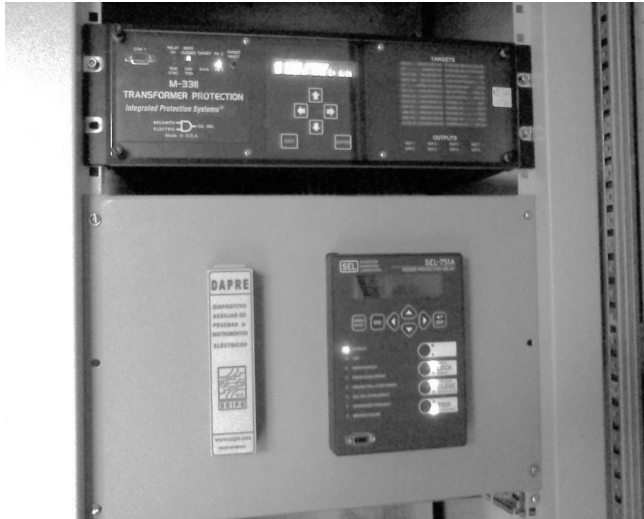
Figura 25. Vista frontal del nuevo tablero de protección
