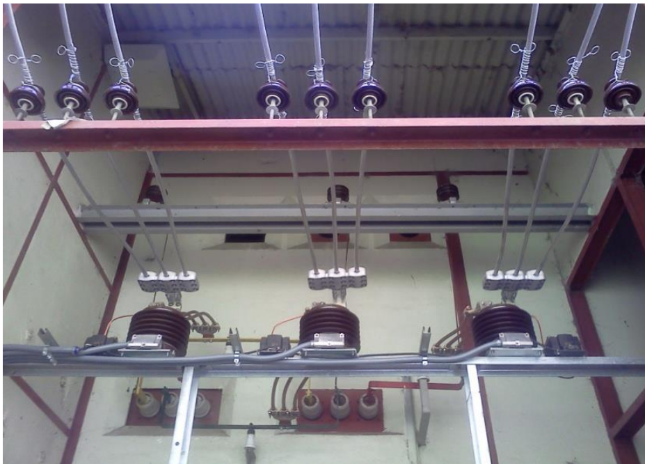
Figura 3. CT's y PT's de salida general de la planta 2,4 kV
