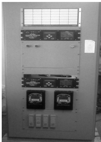
Figura 13. Vista frontal de uno de los nuevos tableros de protección
