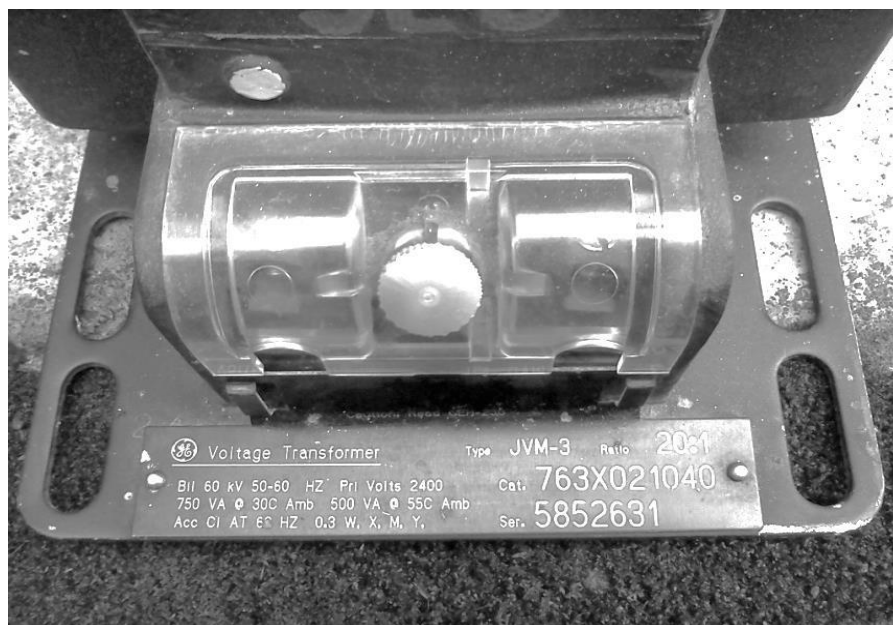
Figura 8. Datos de placa, PT's de salida de la planta 2,4 KV
