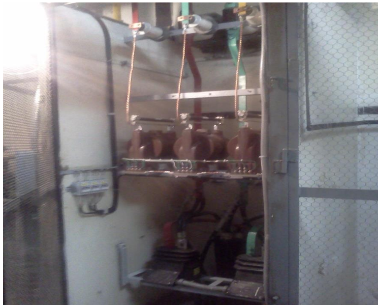
Figura 4. CT's y PT's de salida de la unidad 3
