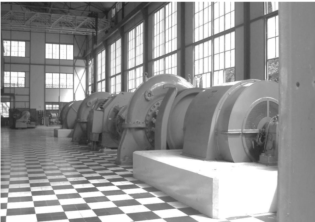
Figura 9. Sala de generadores. Central Hidroeléctrica Santa María
