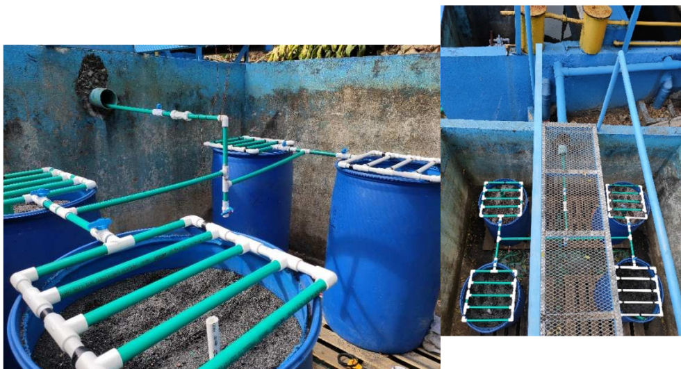
Figura 18. Fotografías de pilotos instalados en la PTAR Los Cenízaros
