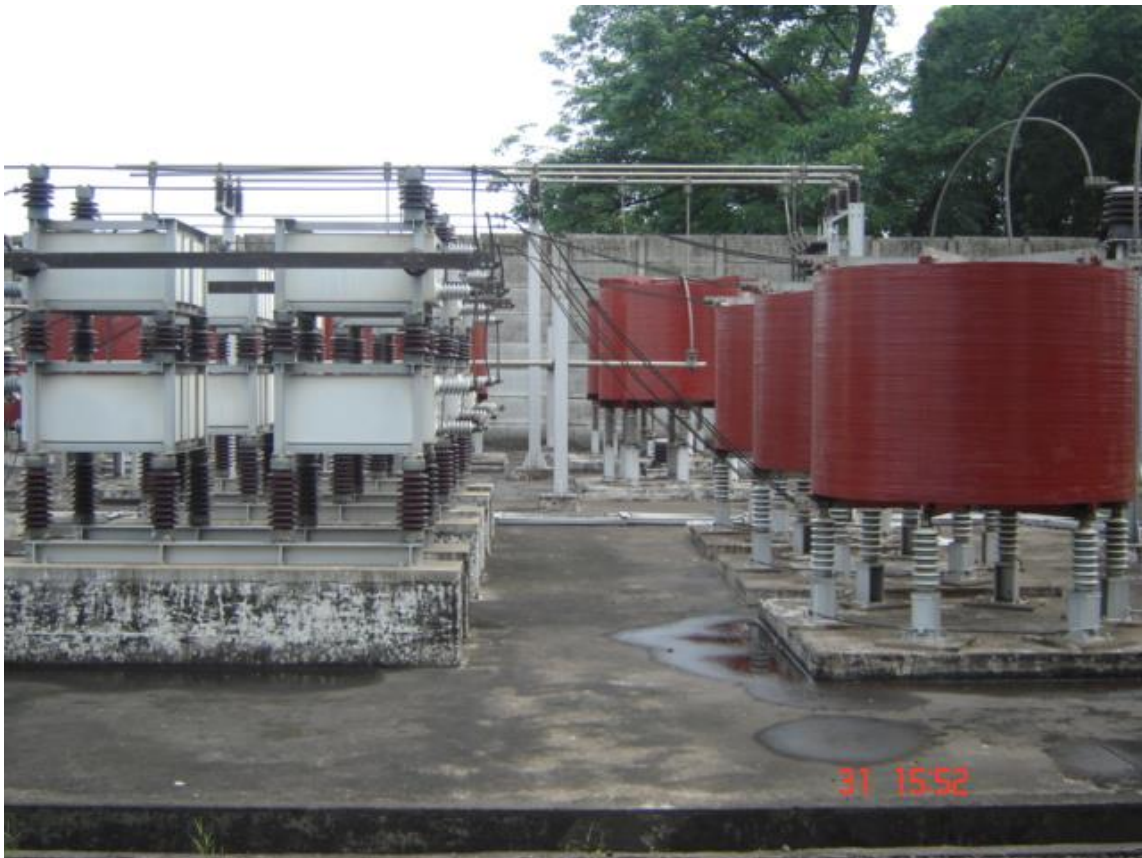
Figura 12. Banco de capacitores y reactores SVC en Sidegua
