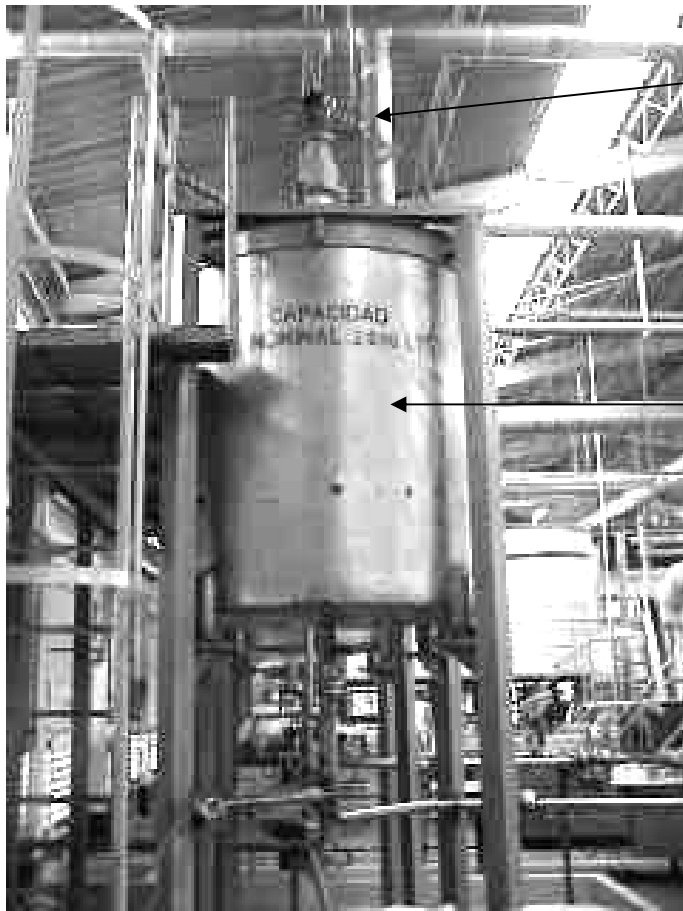
Figura 5. Tanque donde se llevará a cabo la formulación del surfactante
