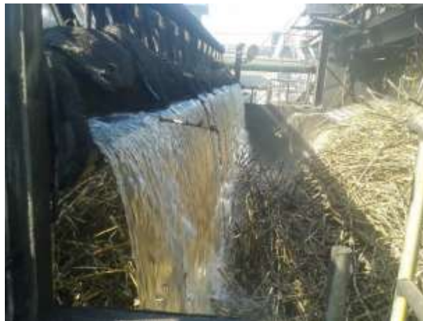
Figura 40. Sistema de lavado con agua por rebalse
