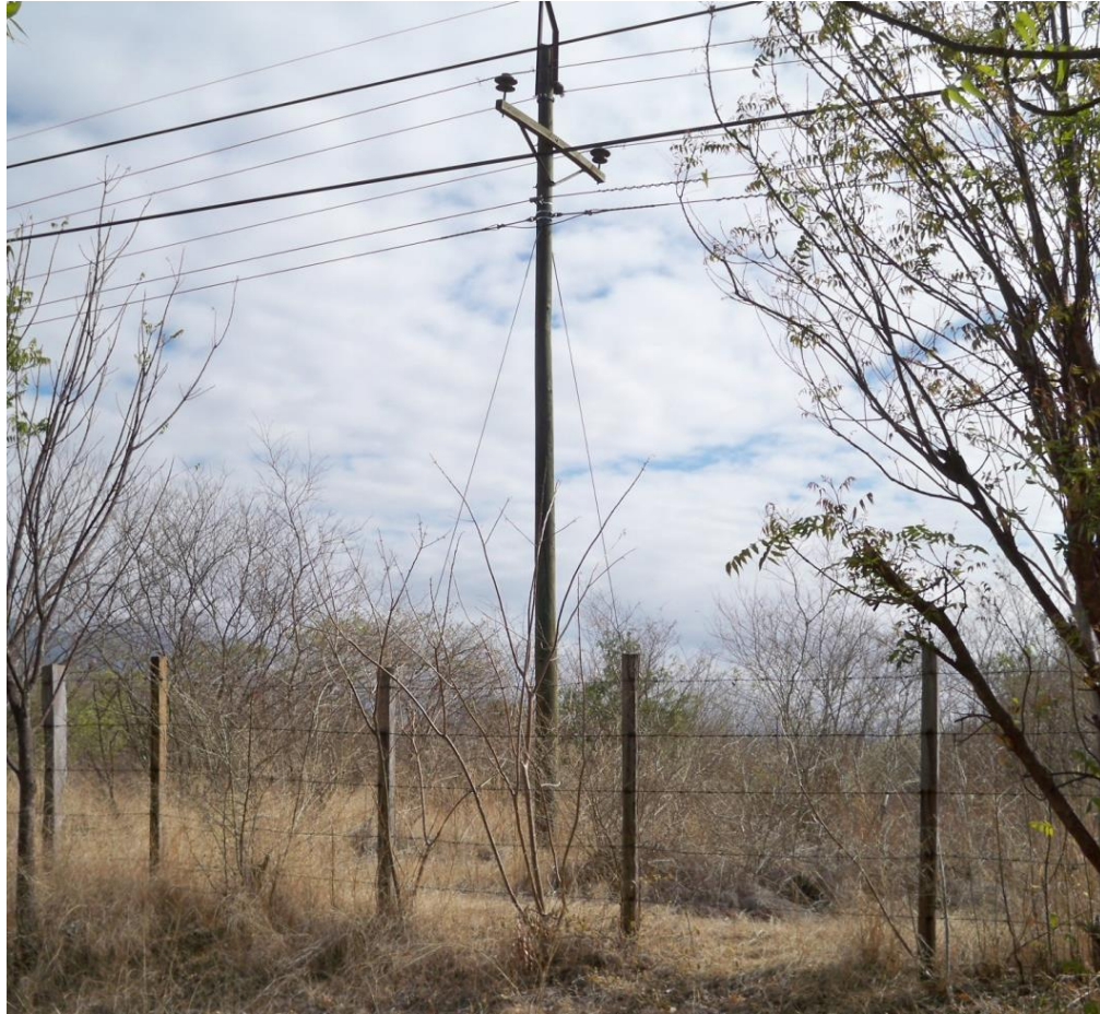
Figura 20. Punto de conexión con la red de 13,8kV
