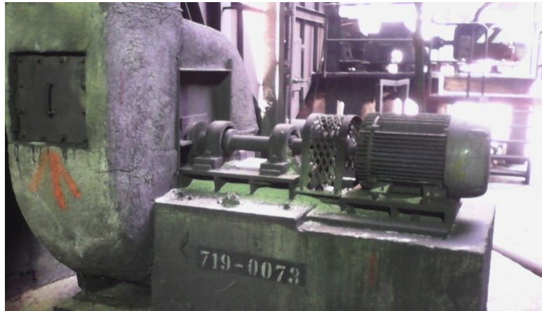
Figura 5. Ventilador Over Fire 1 caldera 4
